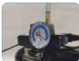
Conexión con bomba de vacío
